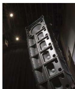
Altavoz con Array de línea Tipo A
